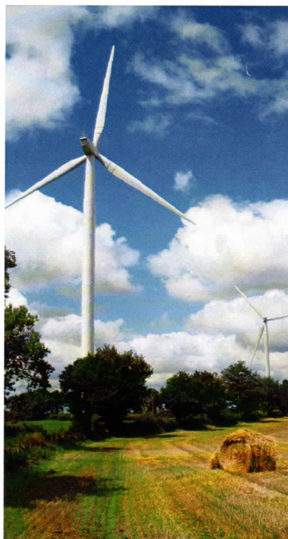
Parc éolien de Coulonges-Thouarsais (79)
